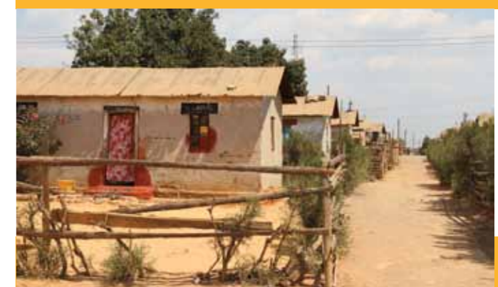
Kwaśne deszcze niszczą dachy i elewacje domów w Kankoyo
